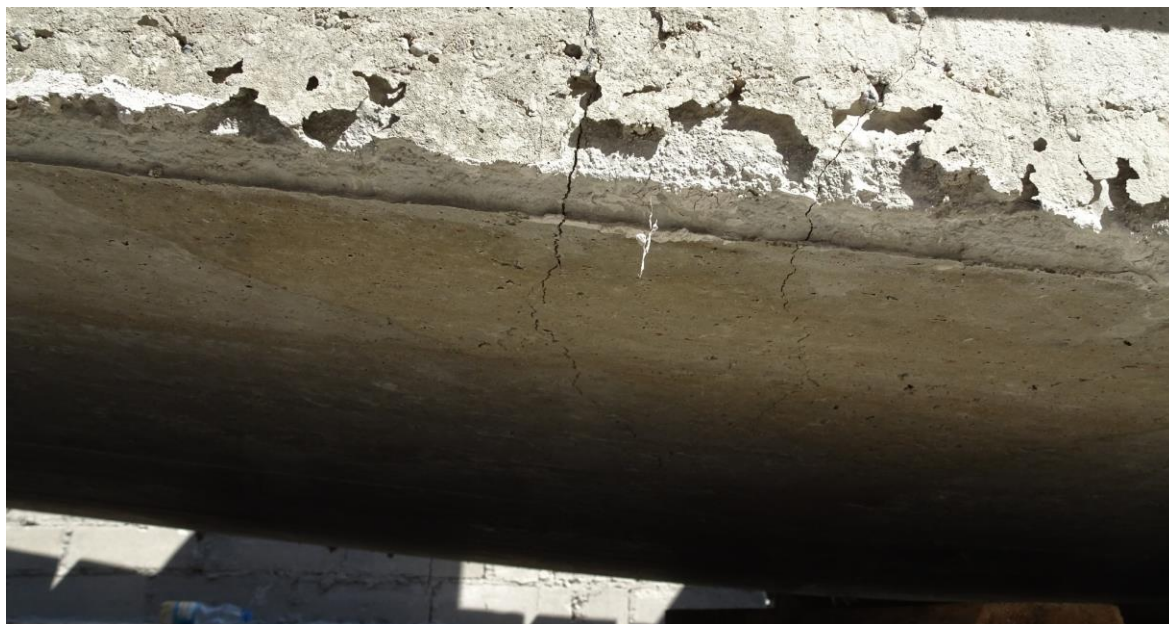
Rys. 51. Zarysowania pasma w 1/4 rozpiętości przęsła
