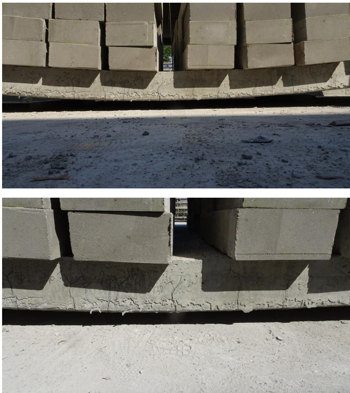
Rys. 50. Widok zarysowań wraz z rysą dominującą w środku rozpiętości przęsła
