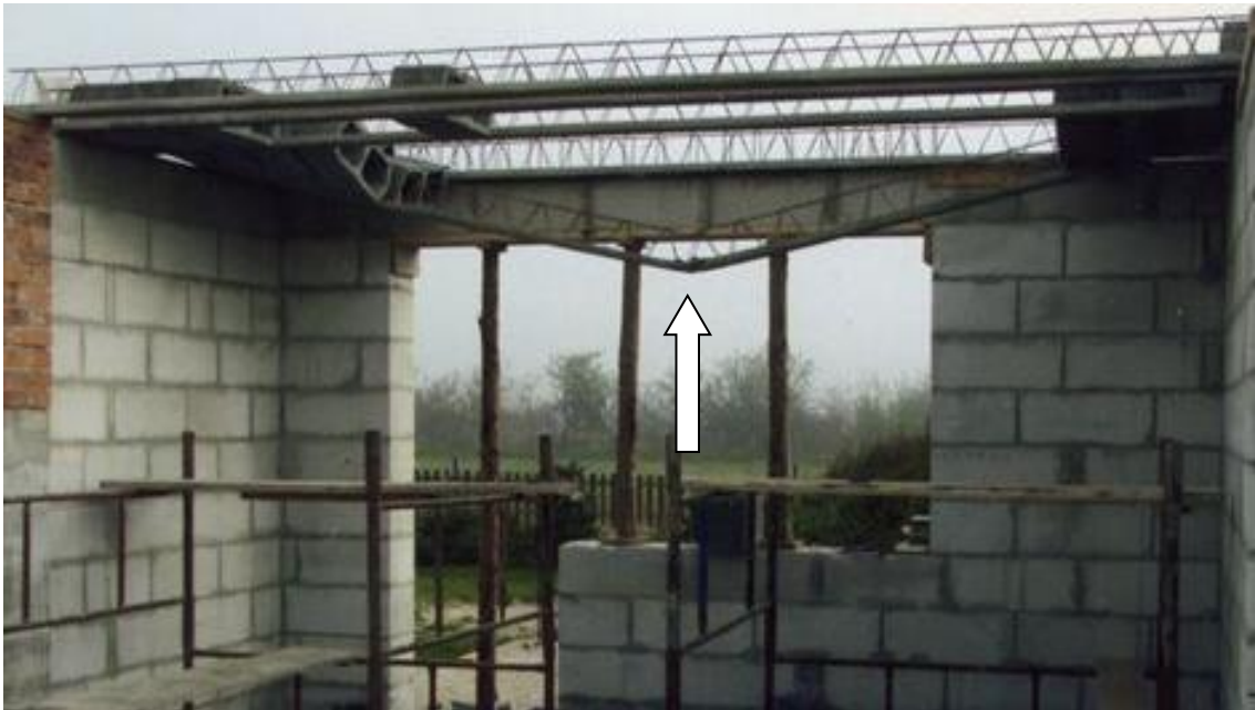
Rys. 3.4. Niewłaściwe podparcie stropu podczas montażu [61] Fig. 3.4. Inadequate support of the floor during assembly [61]
