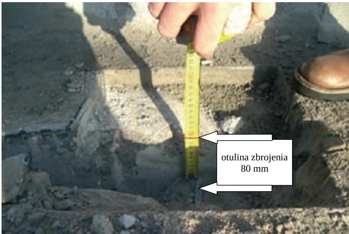
Rys. 3.7. Niewłaściwa otulina zbrojenia w stropie zespolonym typu Filigran [61]
