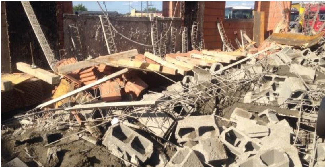
Rys. 3.5. Złe podparcie montażowe, zawalenie stropu podczas montażu [13] Fig. 3.5. Poor assembly support, collapse of the floor during assembly [13]
